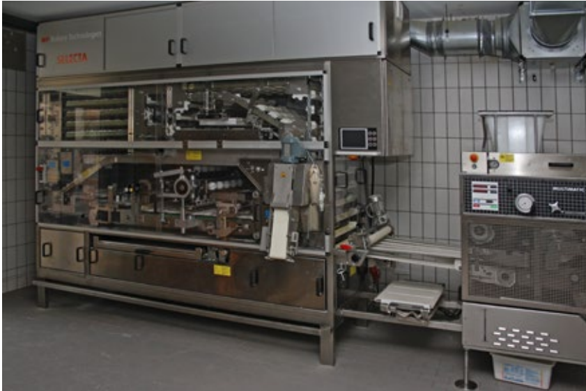
Neue moderne Brötchenanlage mit optimierter Kältetechnik.
